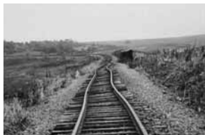
北海道東方沖地震発生 (別当賀～落石間)線路 (平成6年10月)
